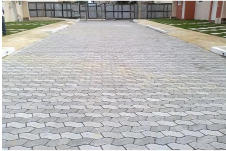
FOTO 1: PISO DE CONCRETO PRÉ-MOLDADO INTERTRAVADO – E=8CM – FCK= 35 MPA
