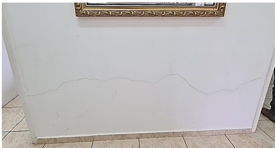
Figura 3 - Trinca horizontal existente próxima a base de alvenaria do corredor
