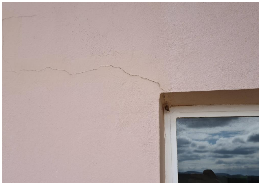
Figura 8 - Trinca 45° em vértice de esquadria.
