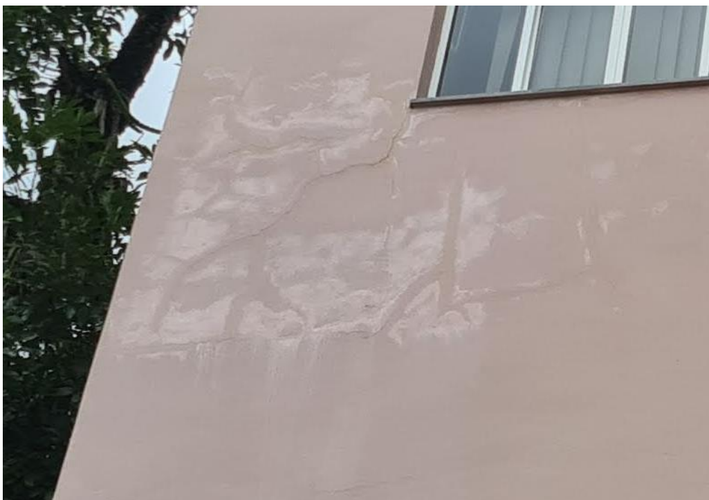
Figura 9 - Fissuração em grande área com eflorescências.
